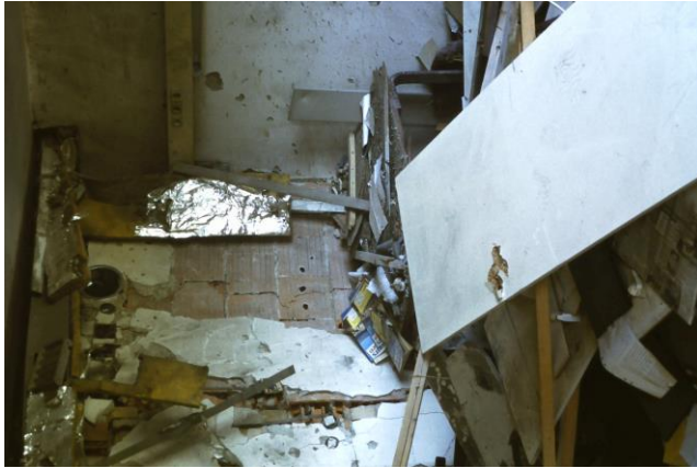
Ravage in het kantoor van Sectie Communicatie.
